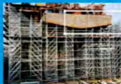
Строительные леса клинового типа
